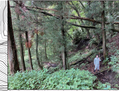
[P5] 下流側斜面脚部は高さ2~4m、洗堀崩壊する
