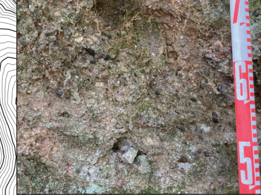
[P8] 下流側の崩壊谷出口部に認められる礫岩、φ5~30mmの円礫で礫種は安山岩、凝灰岩、砂岩と雑多、基質は凝灰質砂
