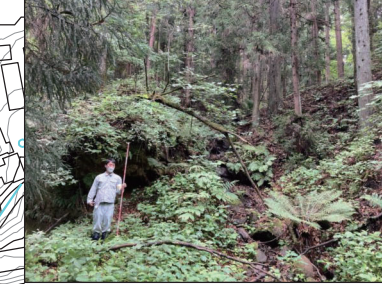
[P6] 下流側の崩壊谷地形の出口部、流出土砂少なく、流水(流量10~20L/分)認められる、写真左側に礫岩が露出する
