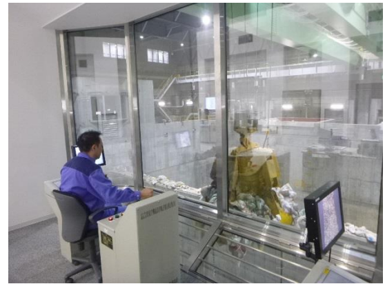
撮影⑤ ごみクレーン
